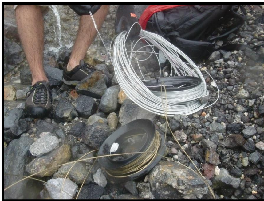
Figura 10: Cable de abajo quedó de color amarillo, deteriorado por los gases ácidos del cráter activo del Rincón de la Vieja, mientras que el cable de arriba es el reemplazo del mismo.
