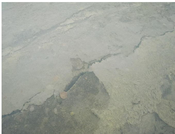
Figura 3: Grietas que bordean el Boquete 2010, con un ancho de hasta 10 cm.
