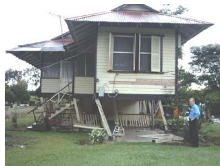
Foto 6: Colapso casa en Parrita
