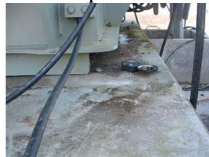
Foto 7: Desplazamiento de transformador del ICE en Parrita
