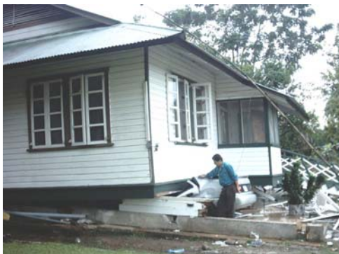
Foto 5: Colapso casa en Parrita
